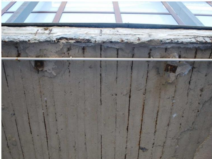
Spód płyty podjazdu – odpadnięcie tynku, odsłonięcie zbrojenia, korozja prętów.
