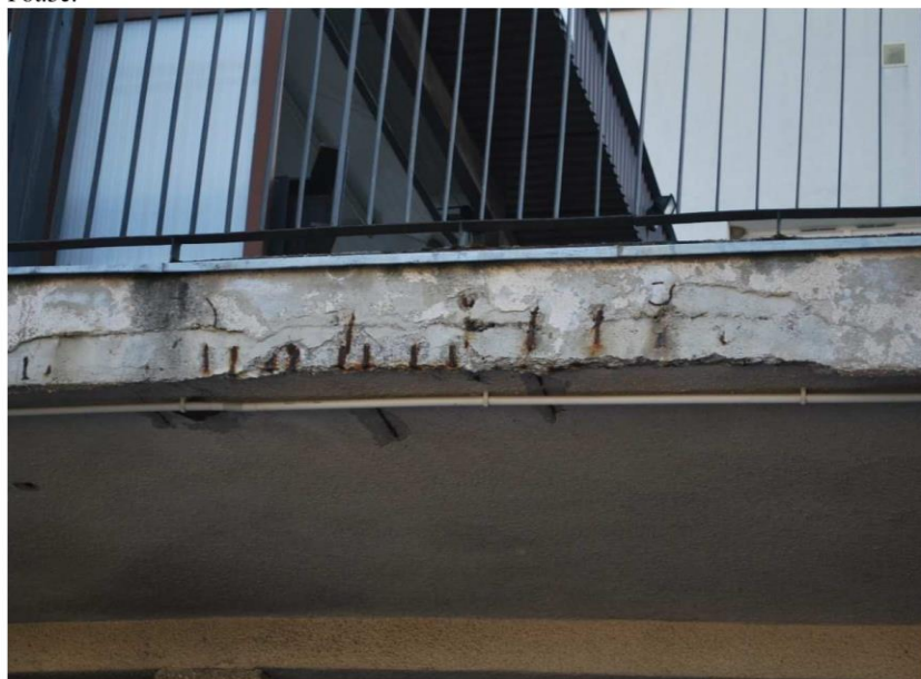
Krawędzie płyt wspornikowych przęsła – odsłonięcie prętów zbrojeniowych i ich korozja.
