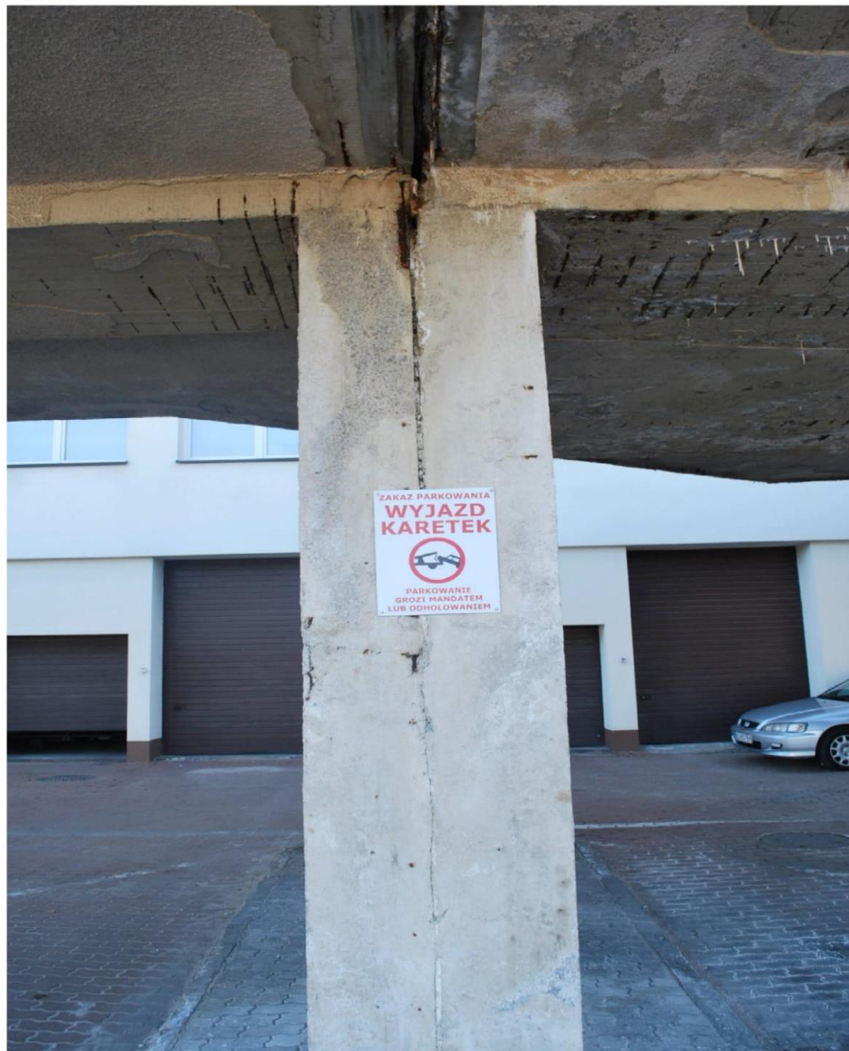
Słupy – brak tynku, stan techniczny dostateczny.
