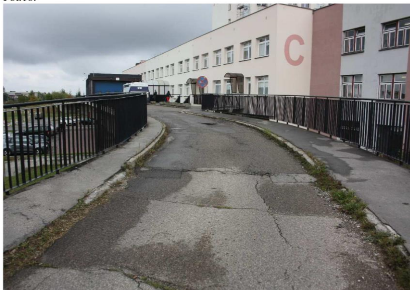
Nawierzchnia asfaltowa – pęknięcia nawierzchni, zapadnięcie na krawędzi przyczółku. Kruszenie się krawężników. Naciekanie asfaltu lanego.
