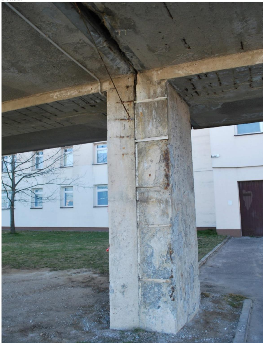
Słupy – brak tynku, stan techniczny dostateczny.
