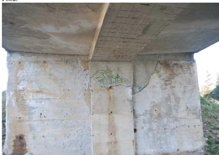
Przyczółki – brak tynku, stan betonu dostateczny.
