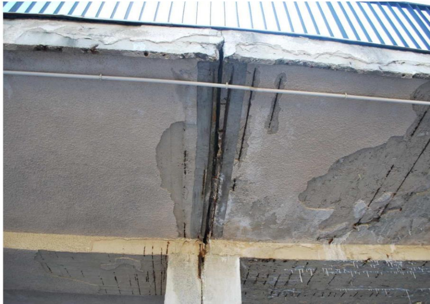
Dylatacja – erozja betonu, odsłonięcie zbrojenia.
