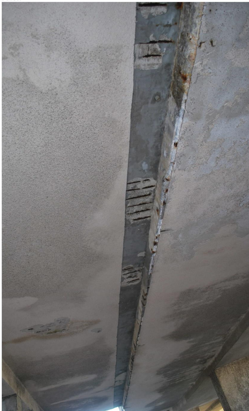
Płyta stropowa łącznika – miejscowe ubytki betonu otulającego dolne pręty zbrojenia.
