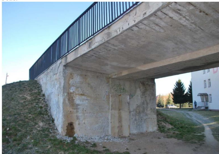
Przyczółki – brak tynku, stan betonu dostateczny.
