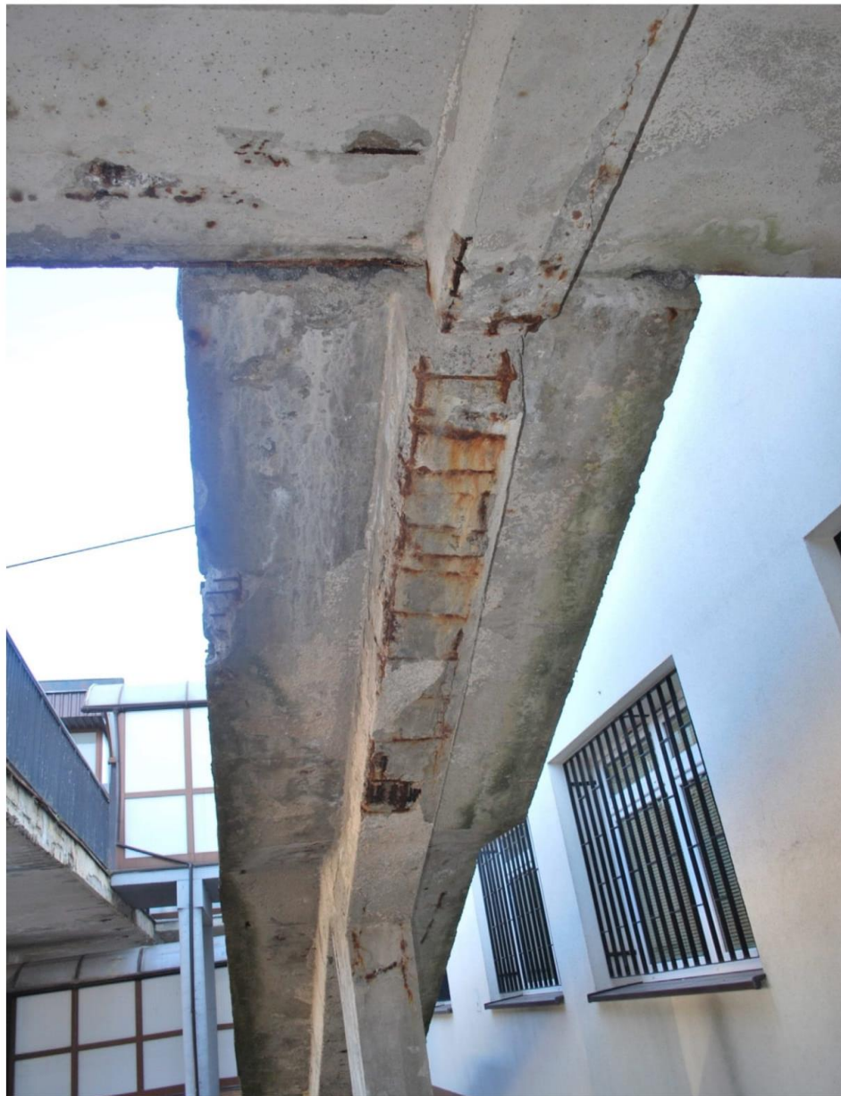
Belka schodów – odpadnięcie otuliny, korozja zbrojenia. Oblupywanie betonu na krawędzi płyty schodów.
